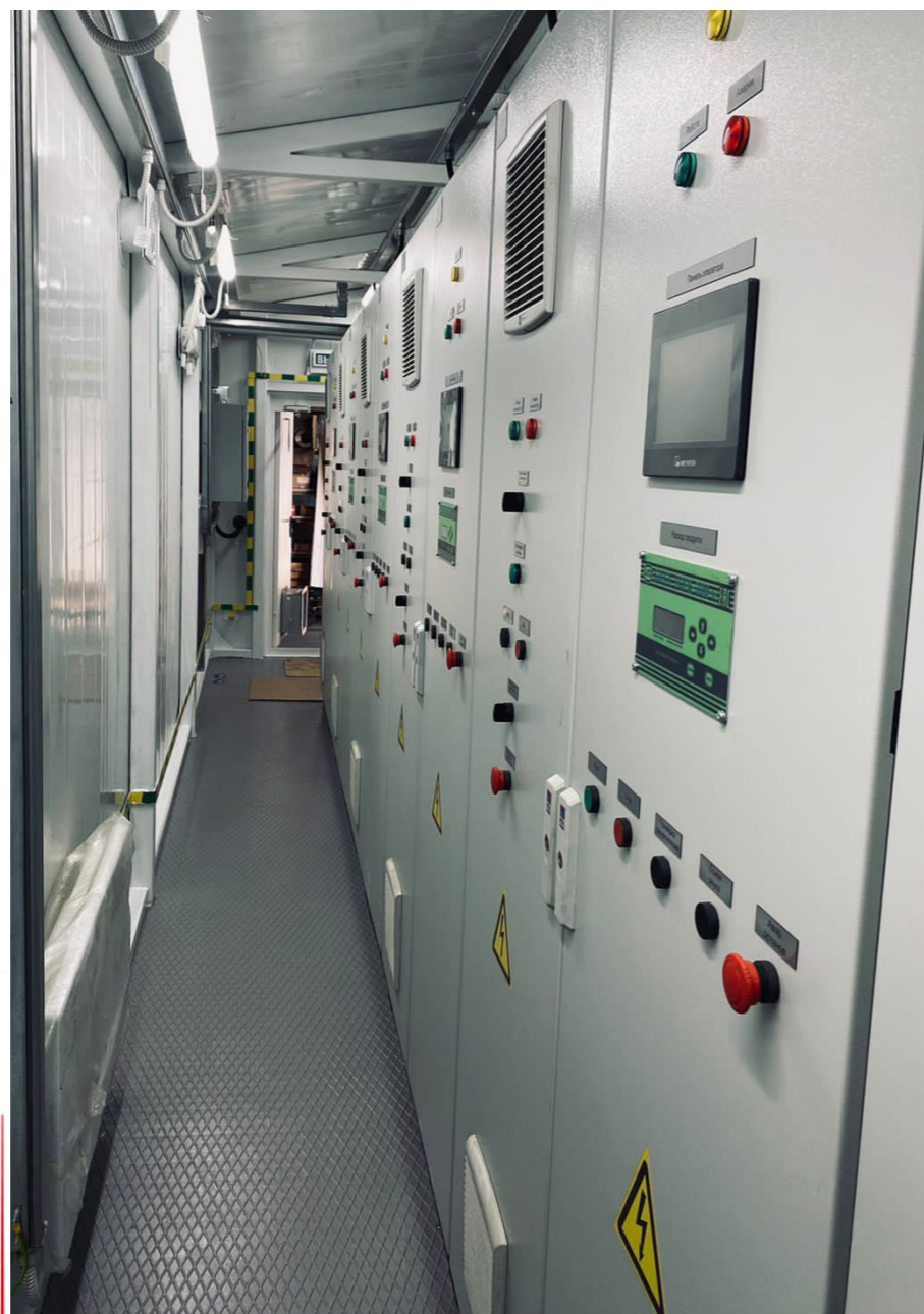
Шкафы системы автоматизации
