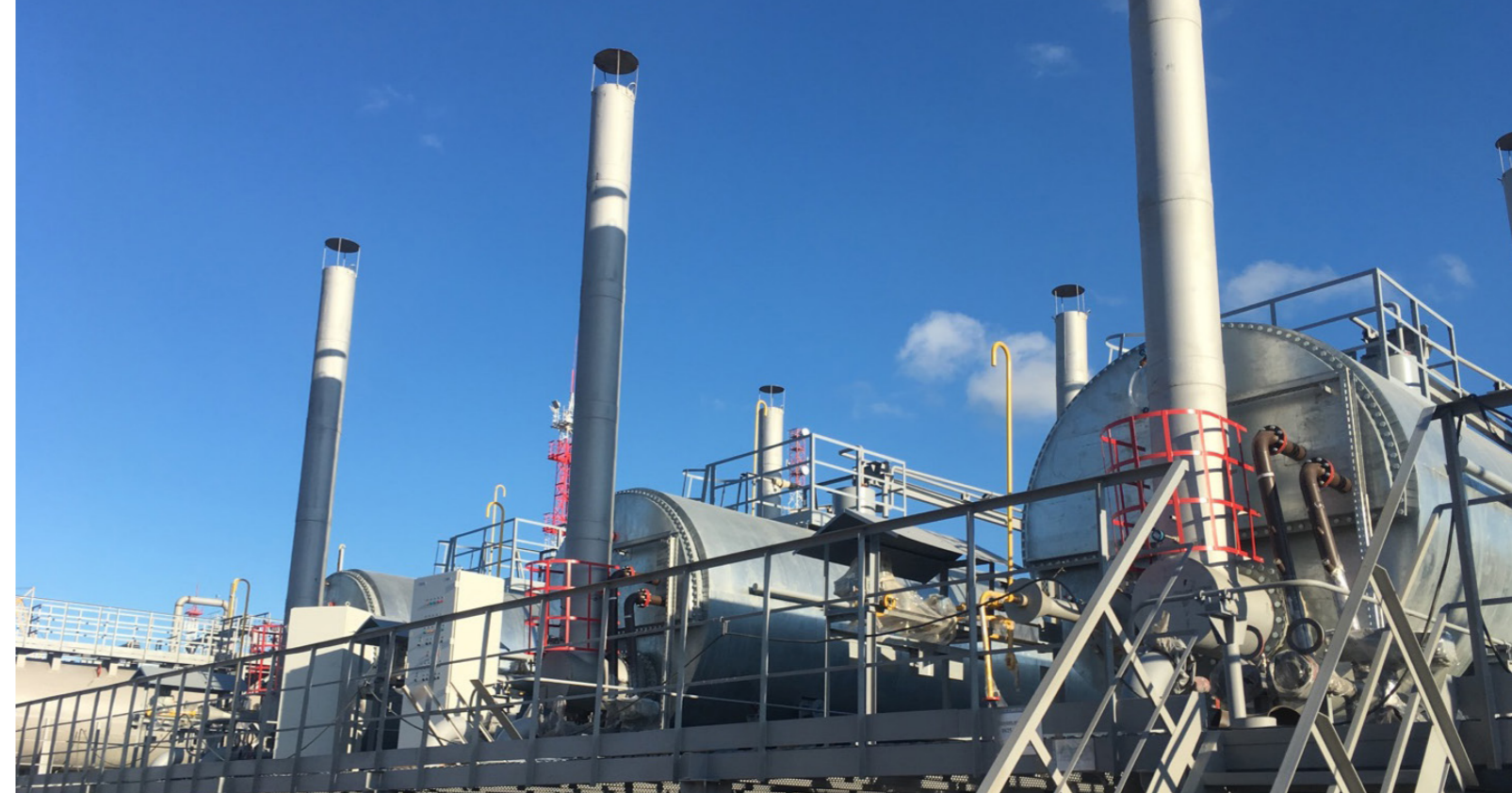
Подогреватели ПП-1,6 на объекте Заказчика
