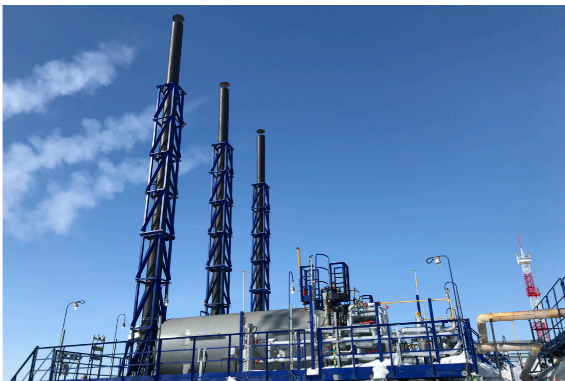
Подогреватели блочный ПБТ-1,6 на объекте
